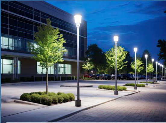
POSTES DE ALUMBRADO.
